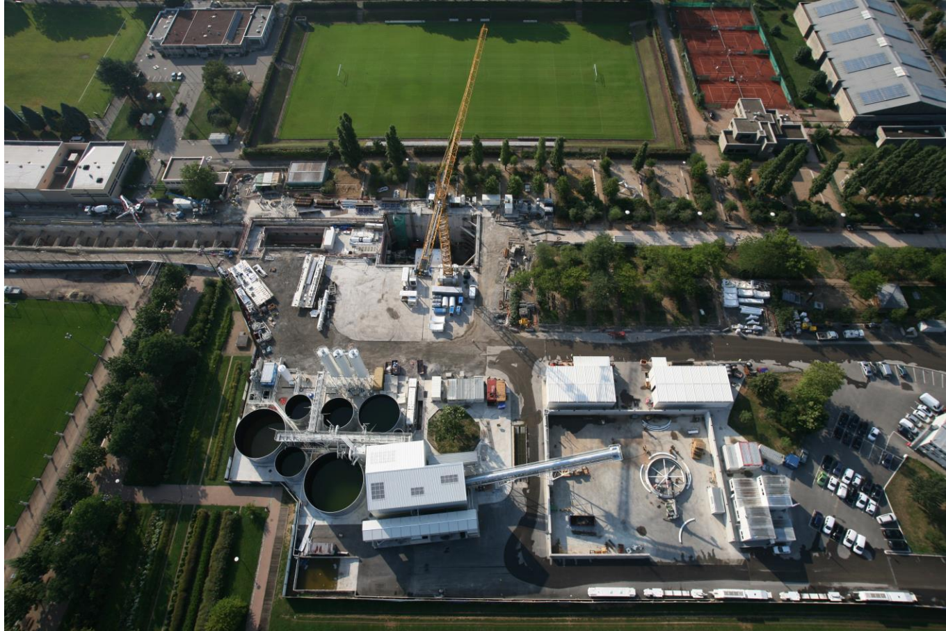
Prolongement Ligne B de Gerland à Oullins – Puits de lancement dans le Parc de Gerland
