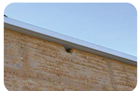
Exemple d'un nichoir pour chauves-souris sous le toit d'une sous-station électrique, réalisé en pisé, à partir de terre crue locale.
